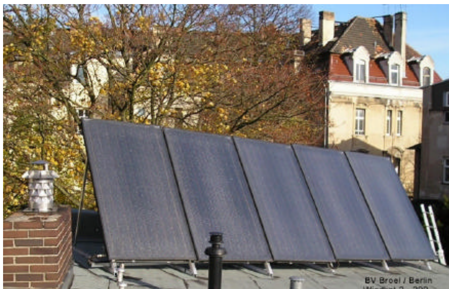
Solaranlage in einem Berliner Hinterhof , Kollektor M 3 , Flachdachmontage
